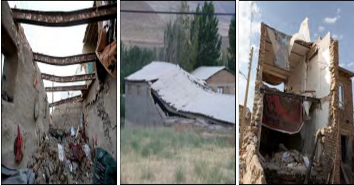
Şekil 1a. Deprem Sonrası Hasar Almış Yığma Yapılar (Razzaghi ve Ghafory-Ashtiany, 2012)
