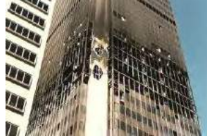
Resim 5. Cam Giydirmeye Cephe Yangını [15]
